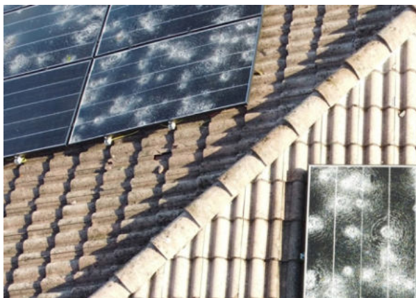
2. Danni all'impianto fotovoltaico
